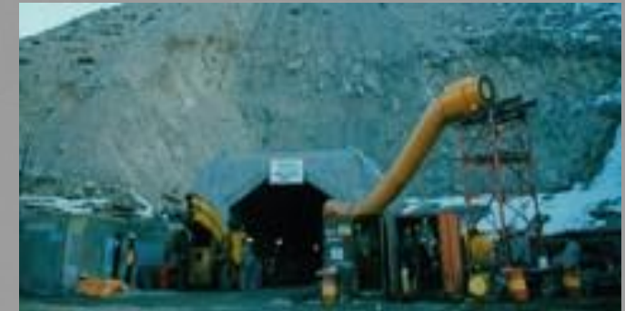
Túnel Haulage nº 2 – Projeto III Panel Mina La Andina Saladillo V Región – Chile / Santa Cruz – Argentina
