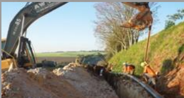
SCGÁS – Companhia de Gás de Santa Catarina - Ramal Vega Sul São Francisco do Sul/SC - Brasil
