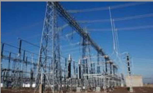
Sistema de Transmissão Associado a Yacyretá Corrientes / Entre Rios e Misiones – Argentina
