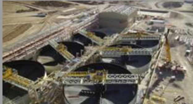
Planta de Agregados e Dosadora Cerro Negro Santa Cruz – Argentina
