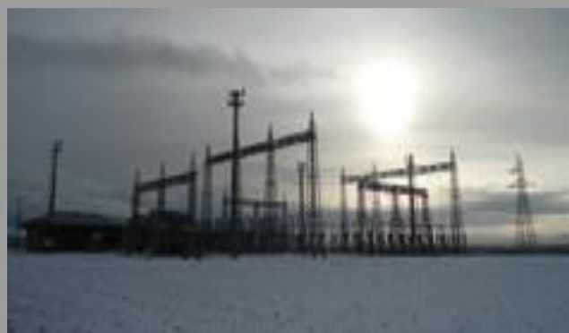
Interconexão Elétrica Santa Cruz – Argentina
