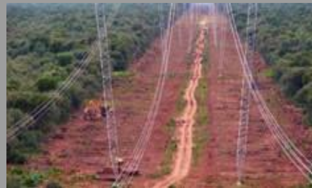
Interconexão NEA (Nordeste Argentino) NOA (Noroeste Argentino) Trecho Leste Formosa e Santiago del Estero – Argentina
